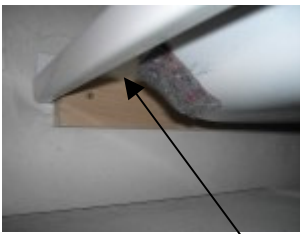
Die Duschenwanne liegt auf der Dachlatte auf
