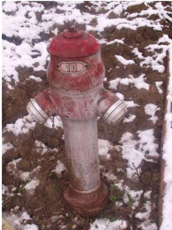
Alter Bernischer Überflurhydrant
